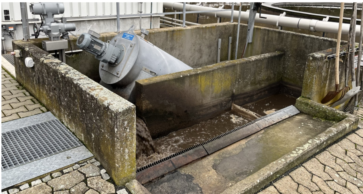
Abbildung: Vorschacht mit Grobrechen und Durchlass zur Belebung sowie Rücklaufschlammschnecke
