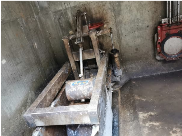
Abb. 16: Waagedrossel RÜB 5 und Schieber Notentlastung
