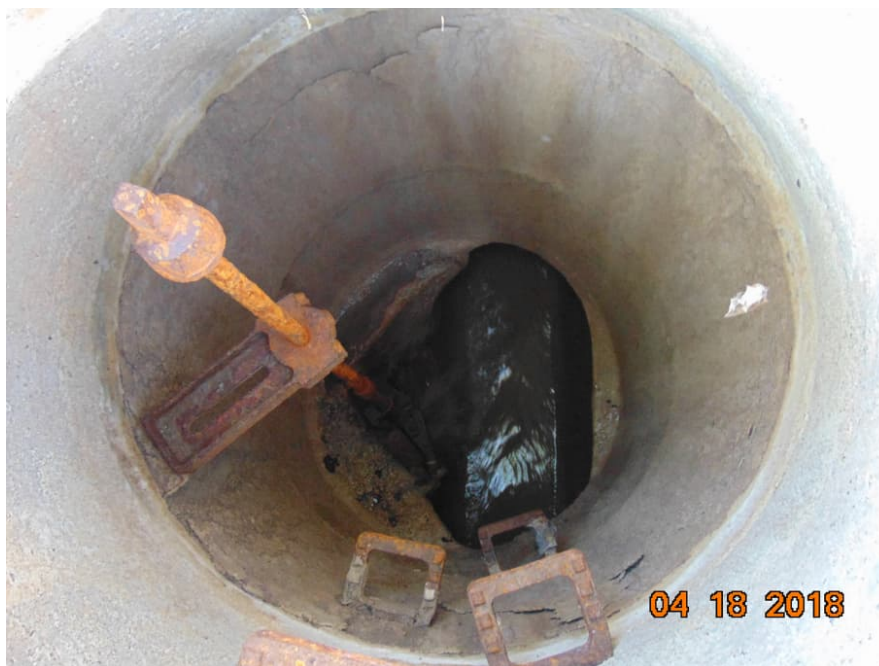
Abb. 35: Drosselschieber SRK 3 Am Brunnhölzlein
