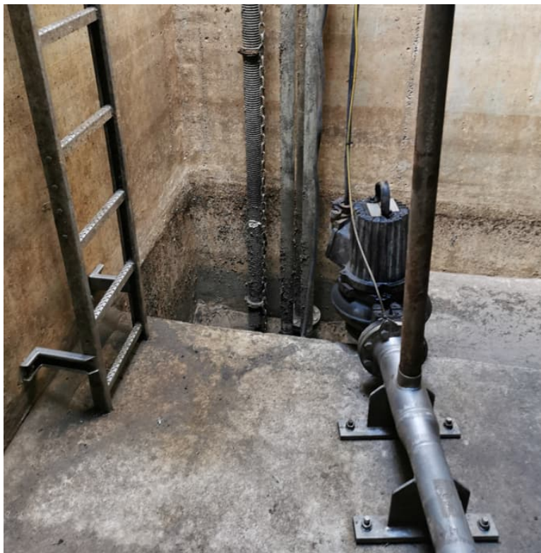
Abb. 18: Strahlbelüfter und Pumpensumpf RÜB 5
