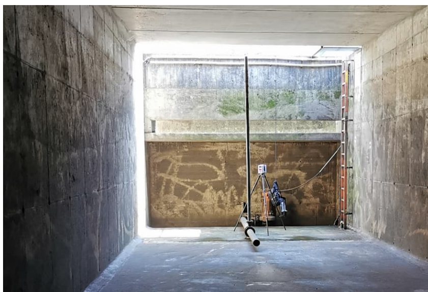
Abb. 8: Strahlbelüfter RÜB 3 Weitramsdorf
